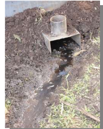
Salida de agua por troneras
